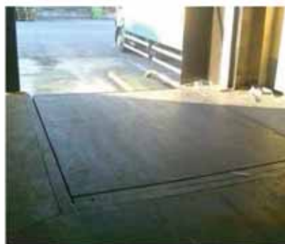
Sin delimitación de rampa de carga
