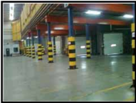
Señalización y protección adecuada de pilares
