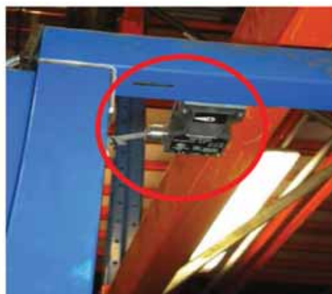
Puerta de acceso a un transelevador
