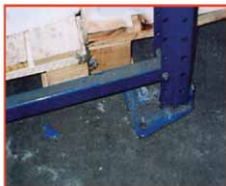
Estantería sin anclaje adecuado (estos deben instalarse según las instrucciones de montaje)
