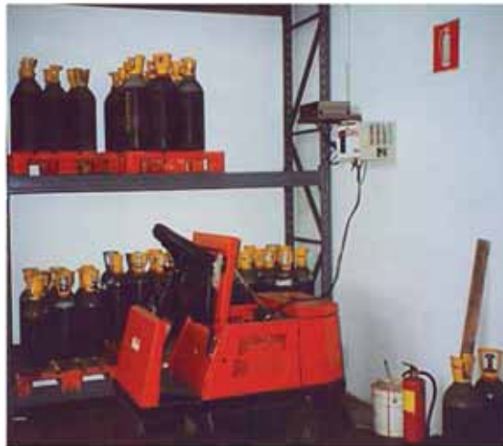
Ubicación inadecuada de los cargadores
