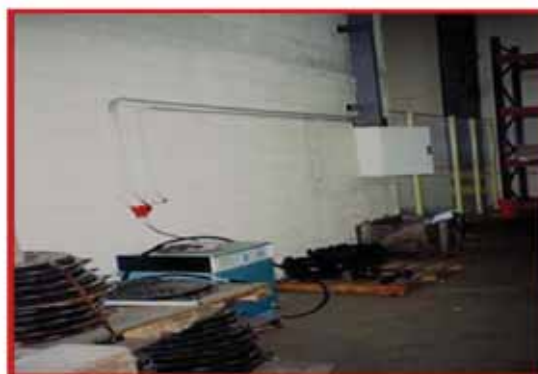
Cuadro eléctrico alejado de la zona carga (mínimo 0,5 m)
